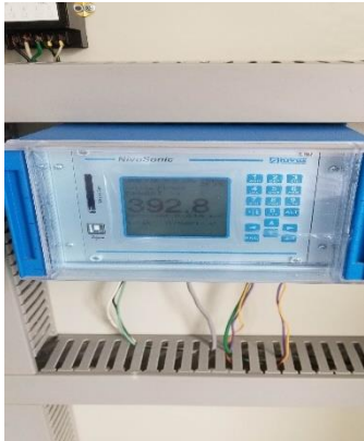
Medición de caudal a la salida de la planta Fuente: Registro fotográfico SSPD – visita SSPD
