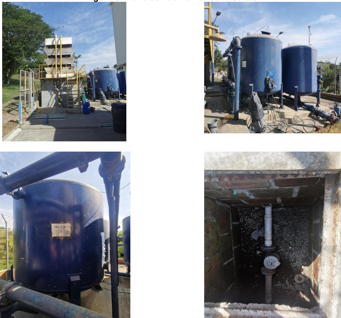
Imagen 15. Planta de tratamiento Puerto Caldas.
