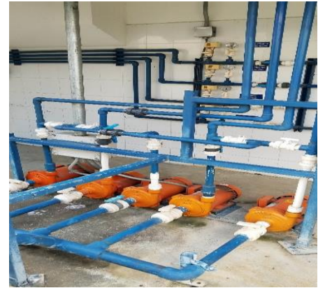
Bombas dosificadoras de cloro
