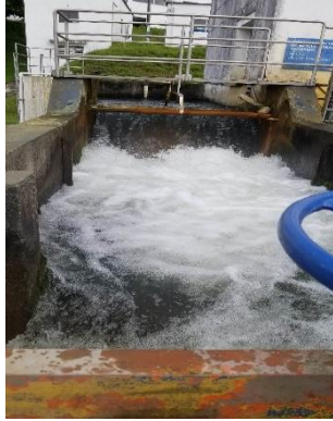
Vertedero y regleta de medición de niveles
