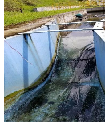
Canaleta Parshall y medición del caudal de entrada
