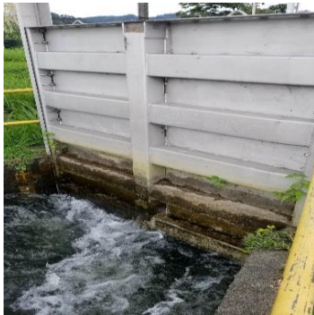
Compuerta de entrada al tanque de carga
