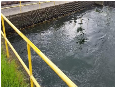
Rejillas y repartición de caudales para tratamiento y generación de energía
