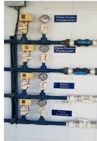
Sistema de dosificación de cloro
