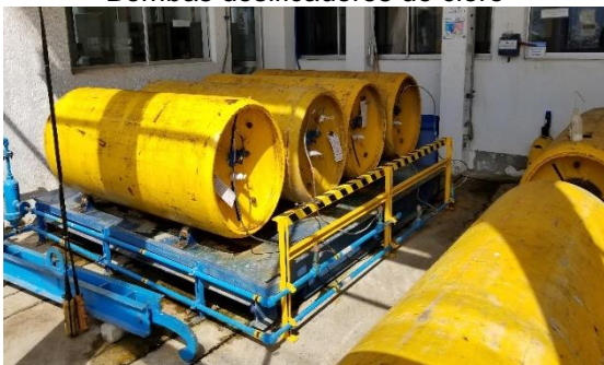
Tanques de cloro gaseoso
