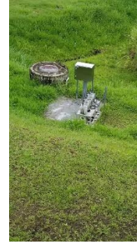
Sensores de medición de parámetros de agua filtrada
