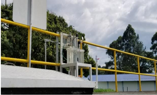
Sensores de medición de parámetros de agua tratada
