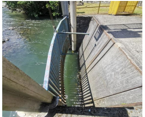
Bocatoma lateral – Rejillas de sólidos gruesos y finos
