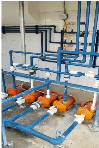
Bombas dosificadoras de cloro
