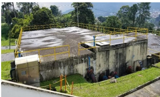
Tanque de contacto de cloro
