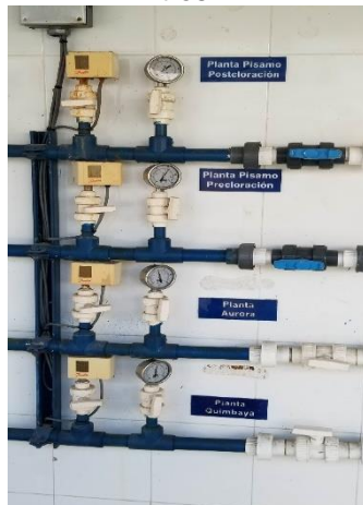
Sistema de dosificación de cloro
