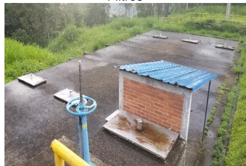
Tanque de contacto de cloro
