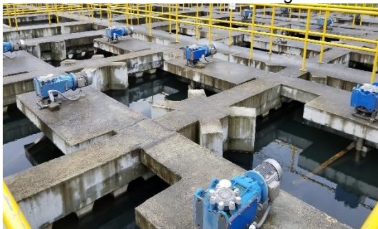
Floculadores mecánicos de eje vertical
