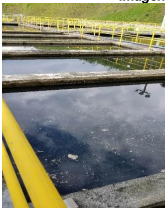
Floculadores mecánicos de eje horizontal
