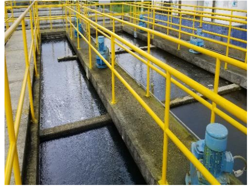
Floculadores mecánicos de eje vertical
