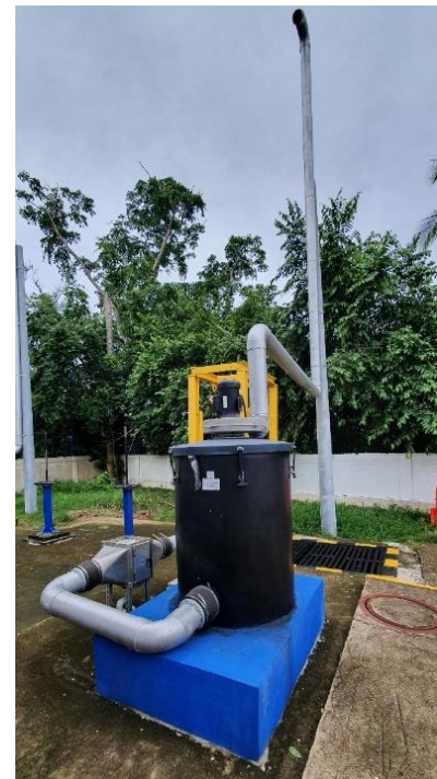
Sistema de control de olores
