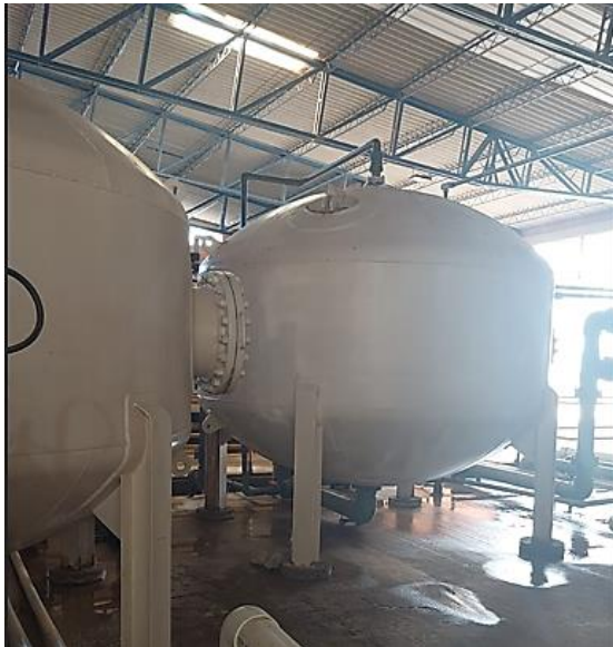
Unidades de filtración multicapa
