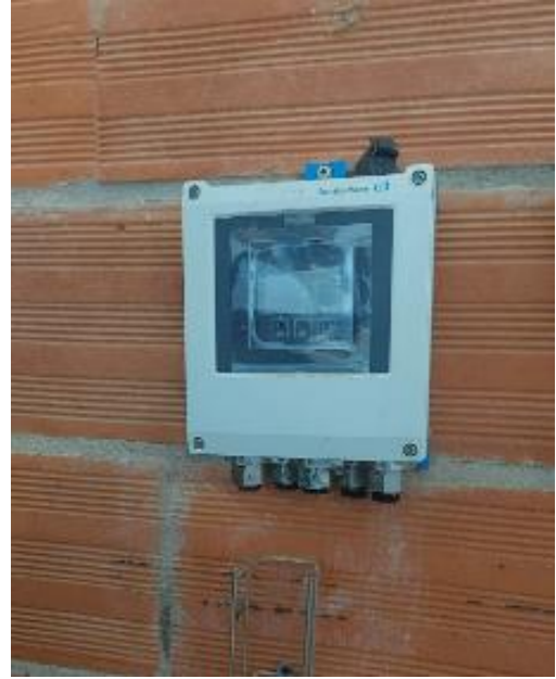
Macromedidor salida planta desalinizadora de 50 l/s
