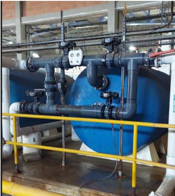
Unidades de filtración multicapa
