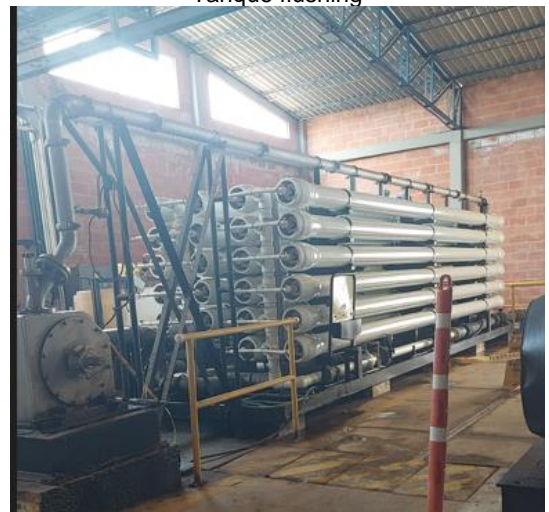
Membranas Osmosis inversa Skid 1
