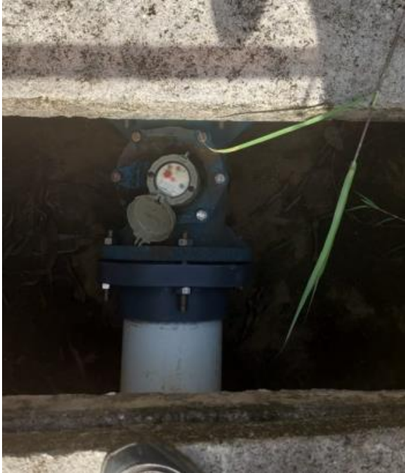
Macromedidor entrada plantas ablandamiento
