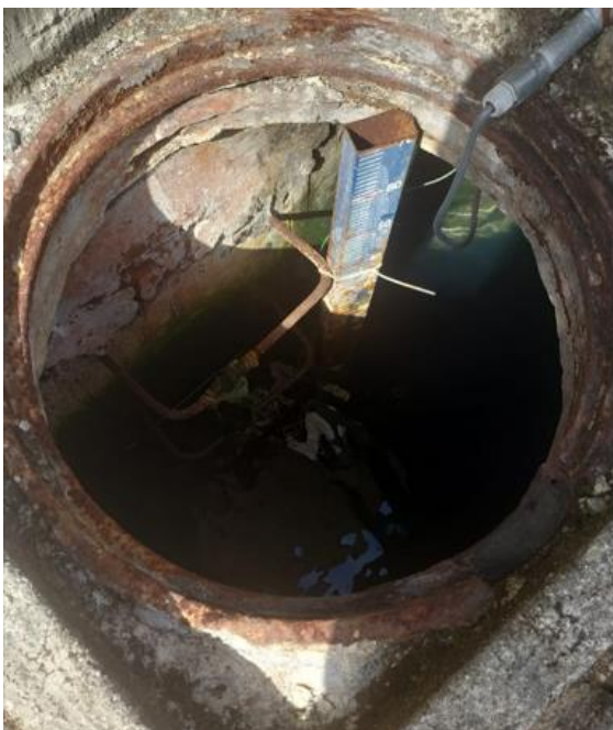
Tanque almacenamiento agua cruda
