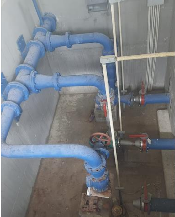
Sistema de bombeo agua cruda
