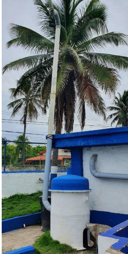
Sistema de control de olores Fuente: Registro fotográfico SSPD
