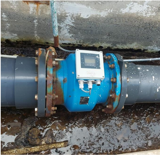
Macromedidor entrada plantas desalinizadoras
