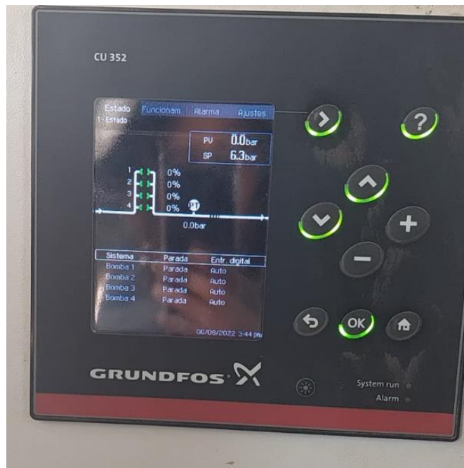
Panel de control sistema de bombeo Grundfos Fuente: Registro fotográfico SSPD
