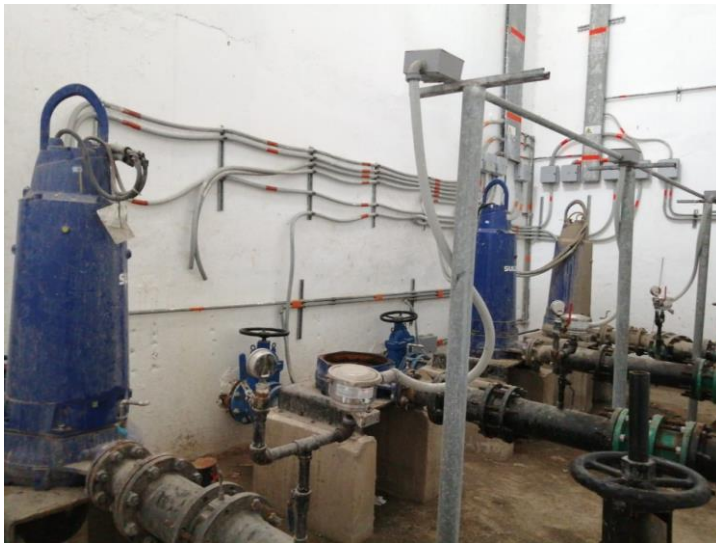
Sistema de bombeo
