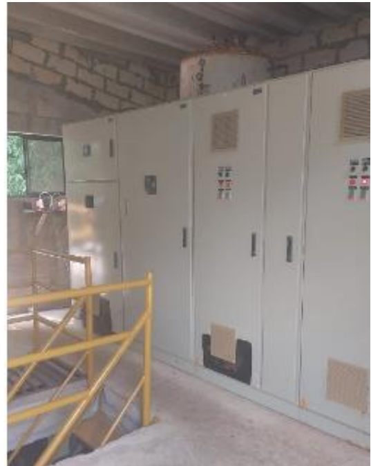
Cuarto de control bombas de impulsión
