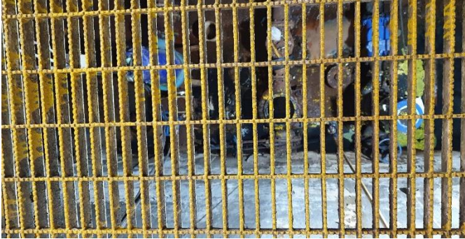
Sistema de bombeo
