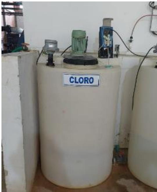
Dosificación de cloro
