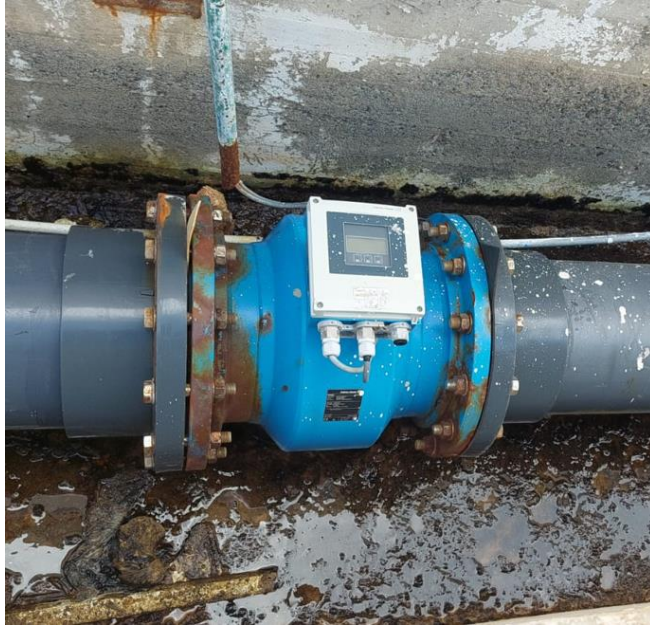
Macromedidor entrada plantas desalinizadoras
