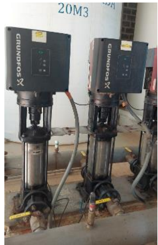
Sistema de bombeo Grundfos
