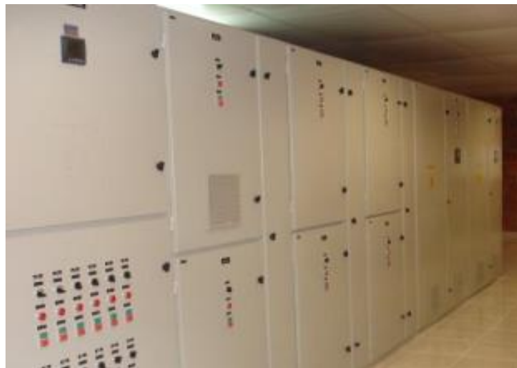
Imagen 11. Centro de Control de Motores
