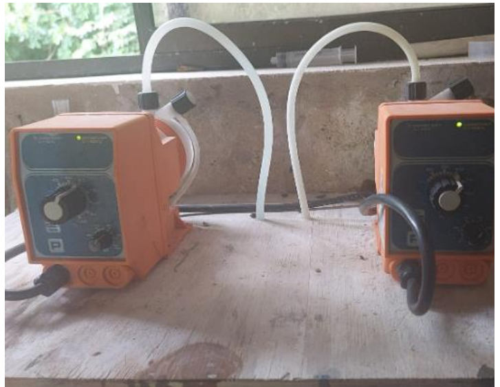
Sistema de dosificación
