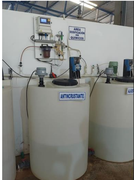
Dosificación de antiincrustante
