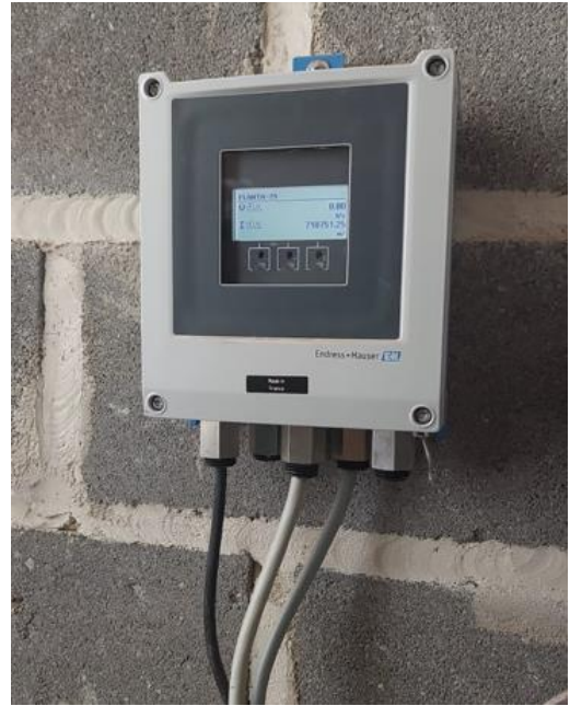
Macromedidor línea de impulsión 25 l/s
