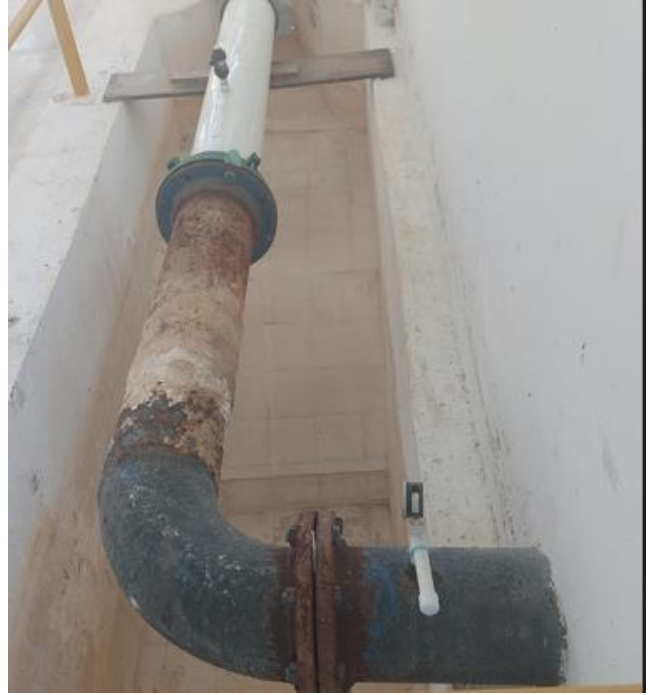
Llegada de agua cruda
