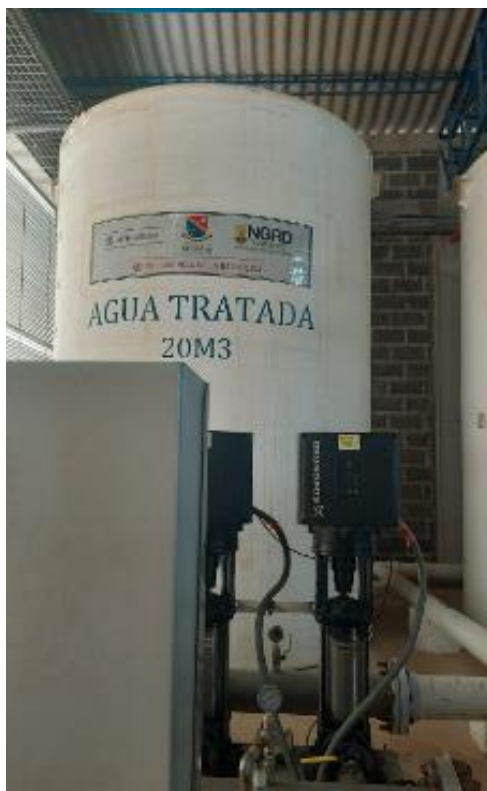
Tanque de agua tratada de 20 m3
