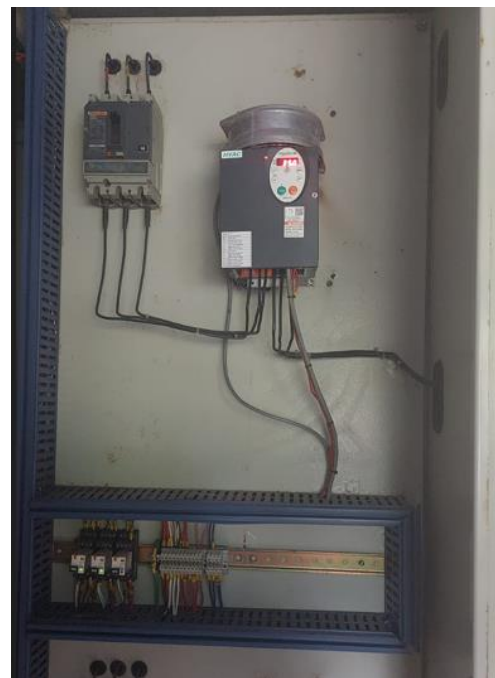
Sistema de control de bombas de agua cruda
