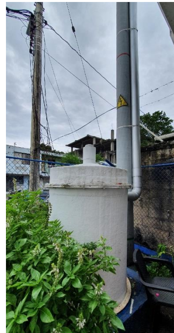
Sistema de control de olores
