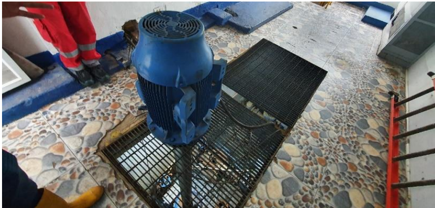
Sistema de bombeo
