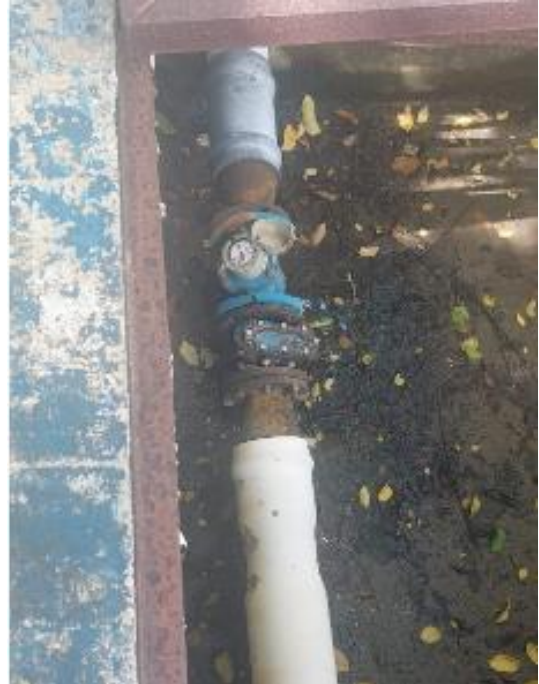
Macromedidor al tanque San Luis
