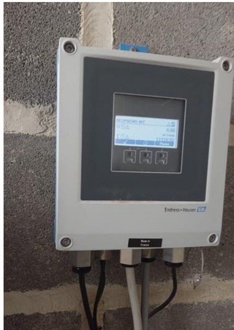
Macromedidor contingencia línea de impulsión 25 l/s Fuente: Registro fotográfico SSPD
