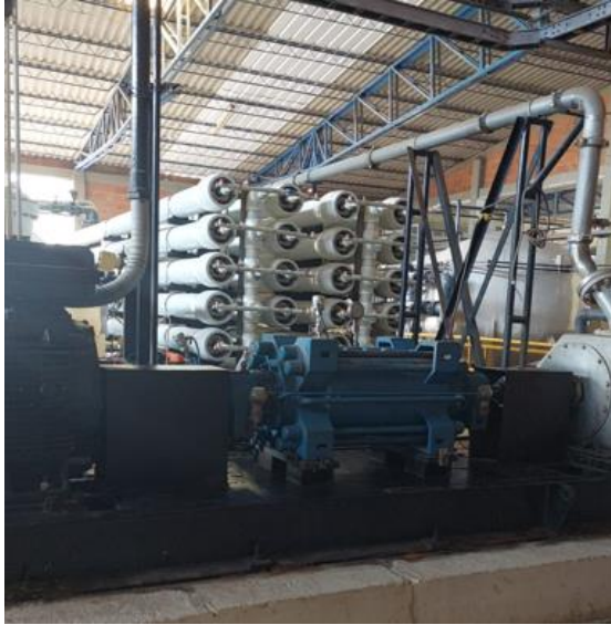
Membranas Osmosis inversa Skid 2
