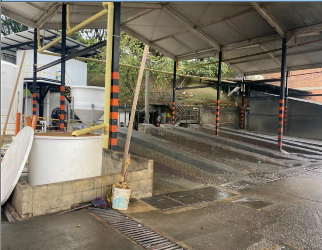
Infraestructura de lavado de vehículos
