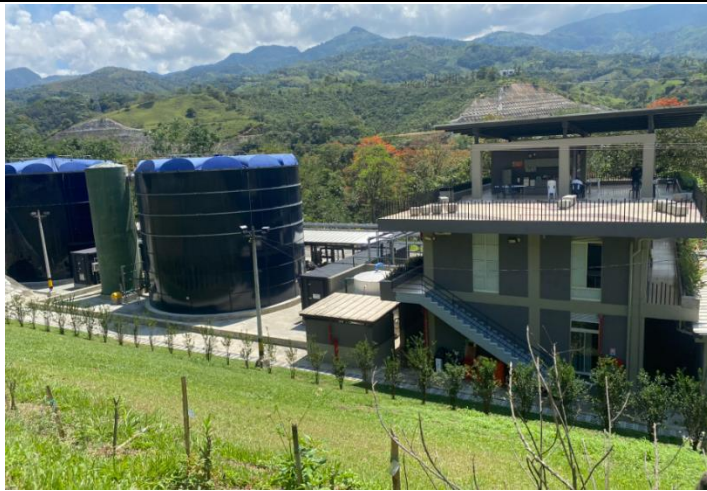
Planta de tratamiento de lixiviados
