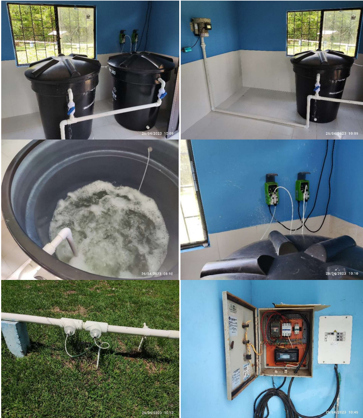
Imagen 9. Sistema de tratamiento de agua potable
