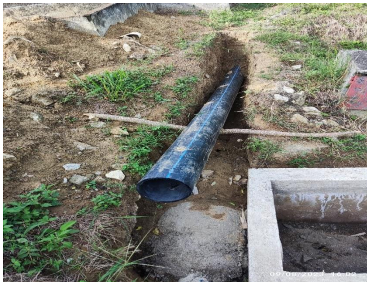
Imagen 3 Tubo Acueducto Regional Costanero.
