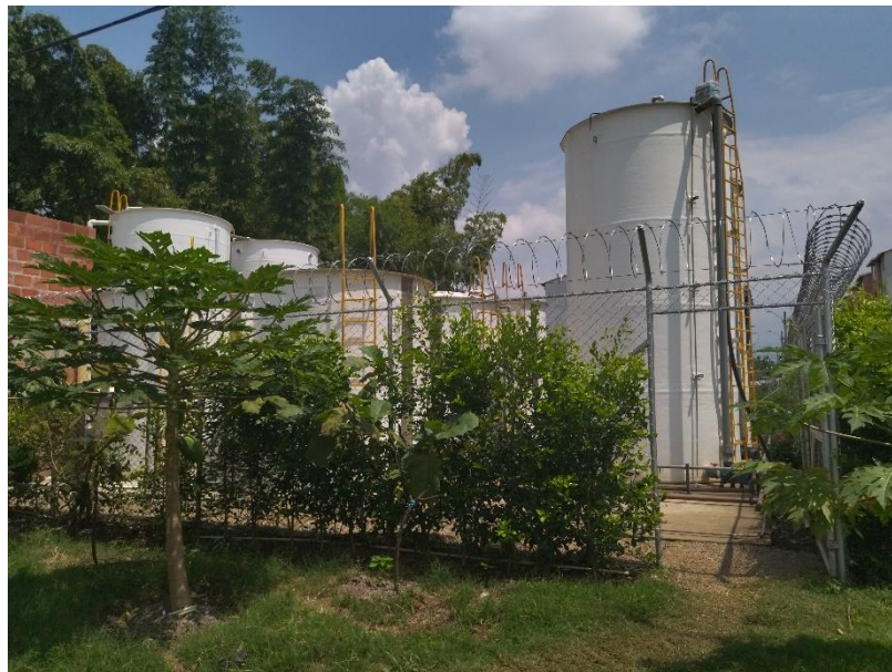
Imagen 25. Vista externa de la PTAR.
