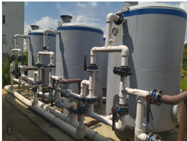
Imagen 8. Vista filtros de carbón activado
