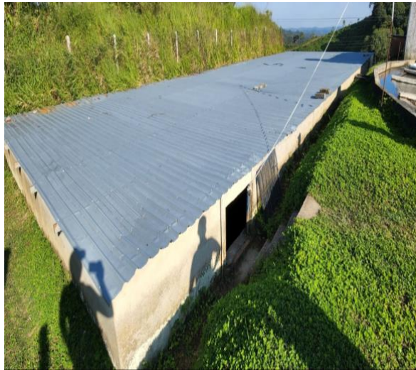
Imagen 12. Tanque de almacenamiento
