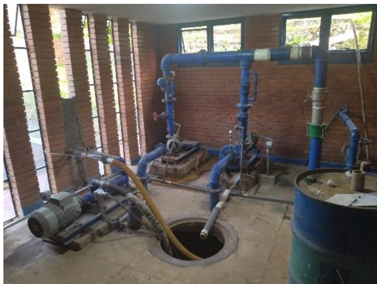
Imagen 12. Estación de bombeo
