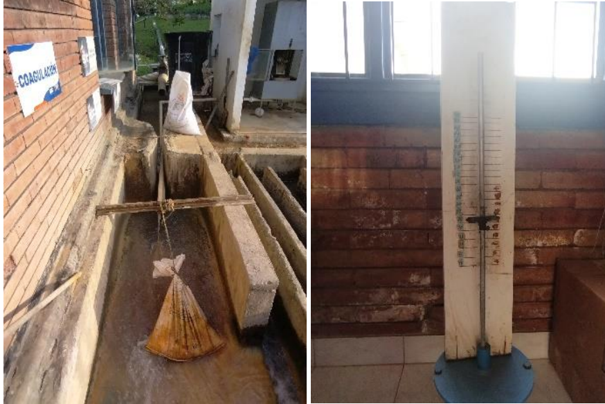
Imagen 8. Módulo de coagulación
