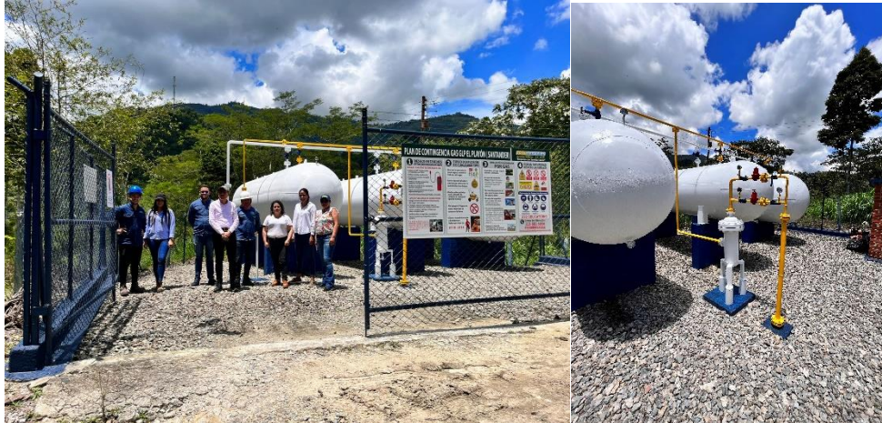
Imagen 2 Tanque Estacionario Finca La Durana en el municipio de El Playón, Santander.
