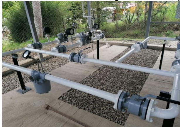
Imagen 01. Infraestructura de la estación de regulación de Guateque en Boyacá
