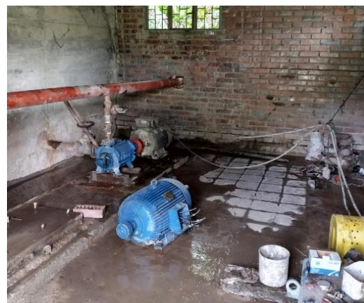
Imagen 6. Cuarto de bombeo 1
