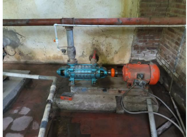
Imagen 8. Cuarto de bombeo 2
