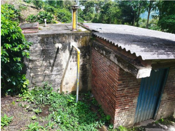
Imagen 7. Tanque de almacenamiento 2
