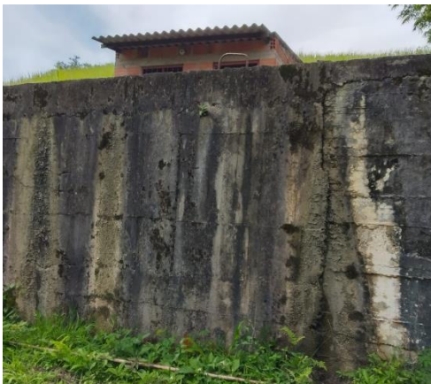
Imagen 5. Tanque de almacenamiento 1
