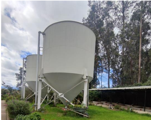
Espesadores de Lodos
