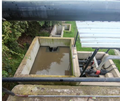
Salida de la PTAR al Rio Bogotá
