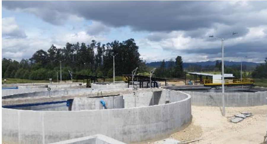
Imagen 7. Vista general PTAR Los Patos
