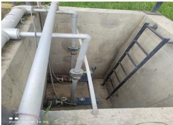
Estación de bombeo de aguas residuales
