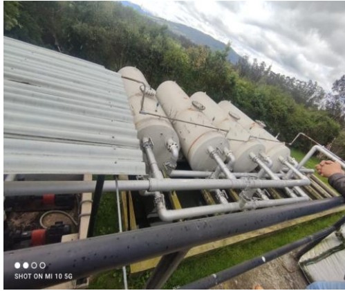
Filtración y Desinfección
