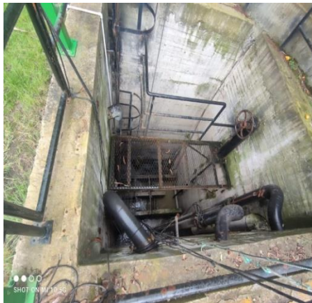
Estación de bombeo de aguas residuales
