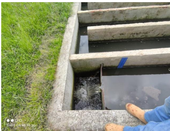
Salida de la PTAR a la Quebrada La Chucua
