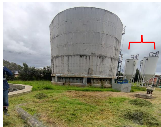
Espesadores de Lodos
