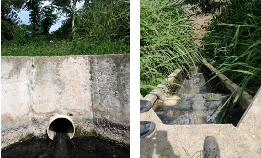
Ilustración 12. Descarga de las aguas residuales y descarga
