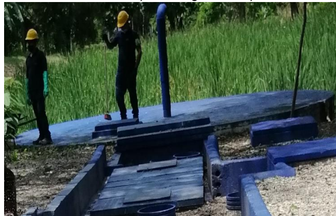
Ilustración 3. Trampa de grasas, un reactor anaerobio con sedimentador, humedal artificial sembrado con especie vegetal de tipo californiana
