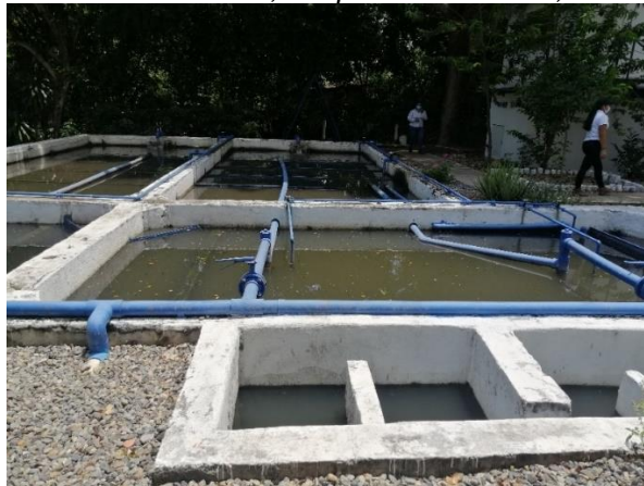
Ilustración 7. Líneas de tratamiento, tanques de aireación, sedimentadores, cloración
