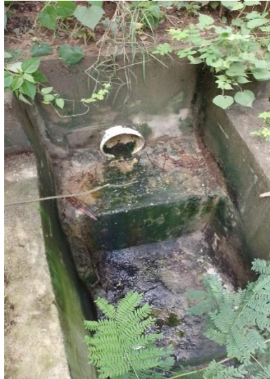
Ilustración 14. Descarga de las aguas residuales
