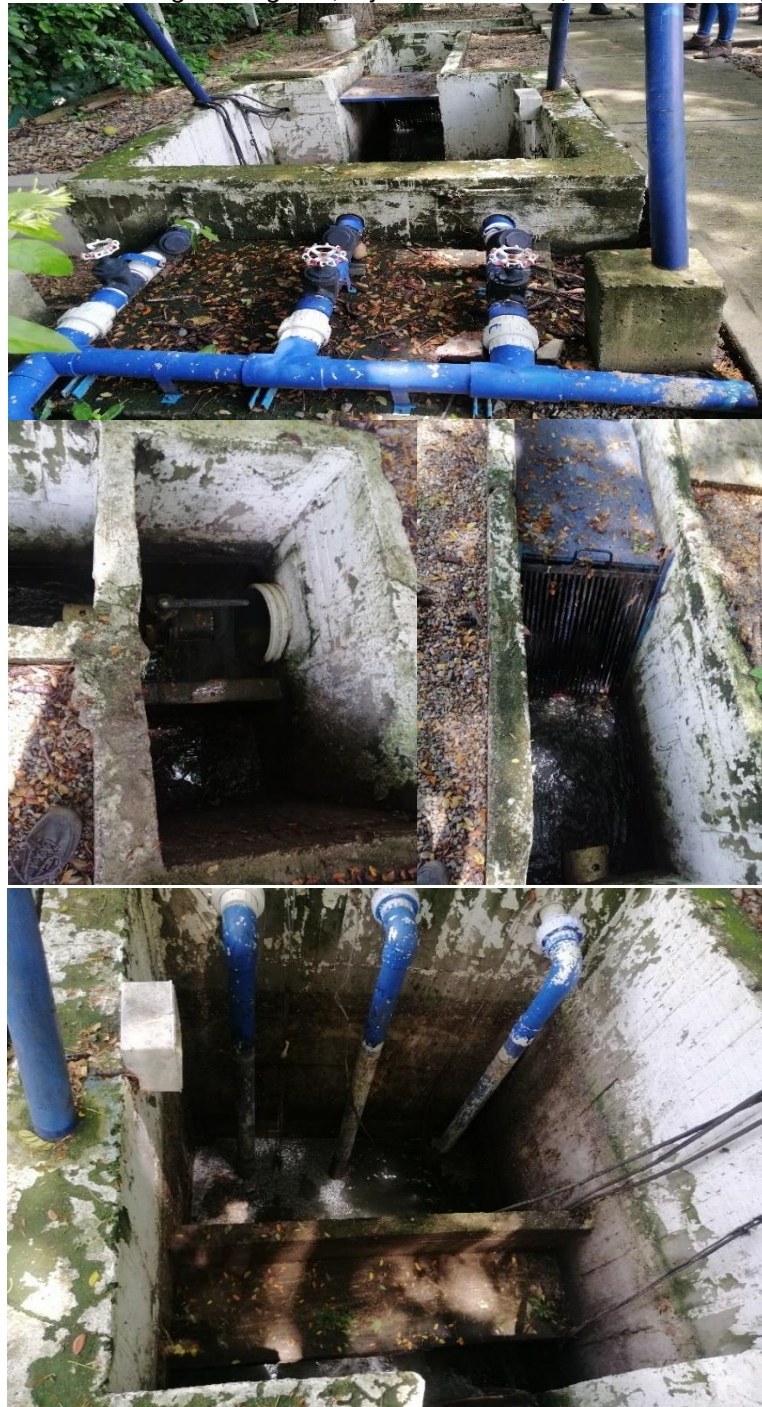
Ilustración 6. Descarga de ingreso, rejillas de Cribado, Bombas Sumergibles
