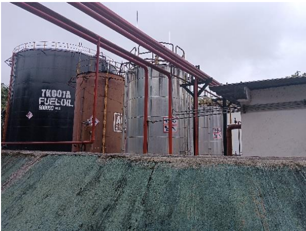
Figura 17 Registro Fotográfico Almacenamiento de combustible
