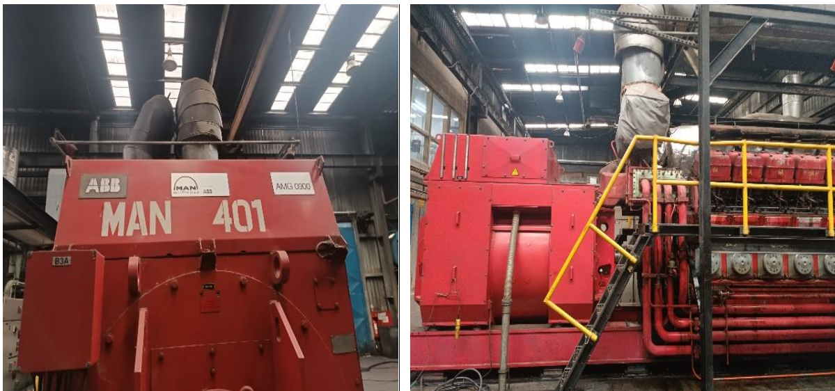
Figura 11 Registro Fotográfico Grupo electrógeno 401 MAN-ABB
