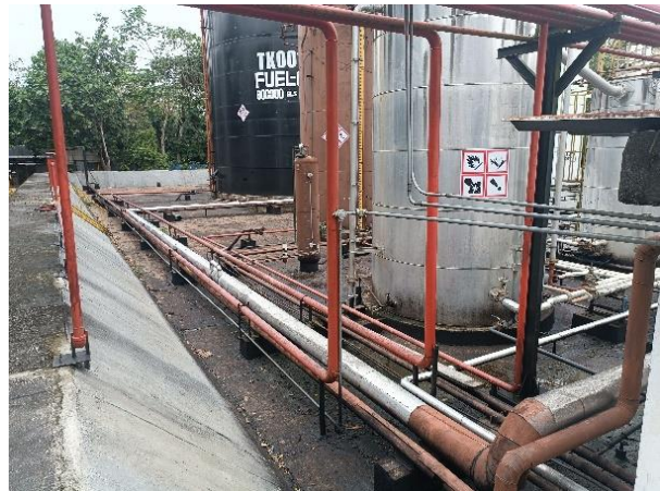
Figura 18 Registro Fotográfico Dique para contención de derrames
