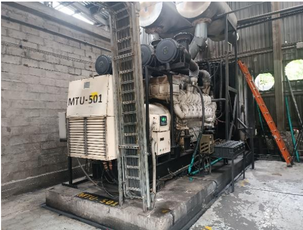
Figura 13 Registro Fotográfico Grupo electrógeno 501 MTU- MARATHON
