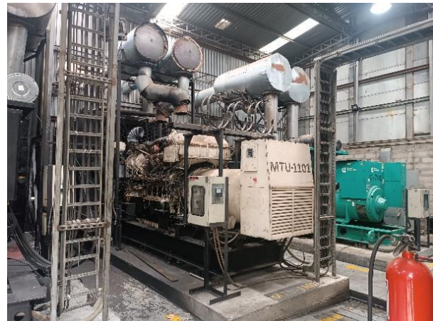
Figura 16 Registro Fotográfico Grupo electrógeno 1101 MTU- MARATHON
