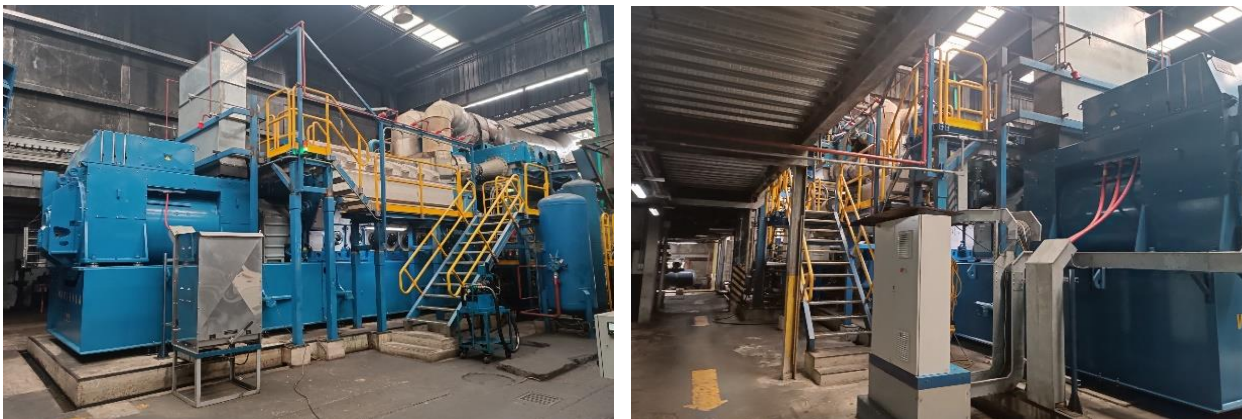
Figura 9 Registro Fotográfico Grupo electrógeno 101 WARTSILA-ABB
