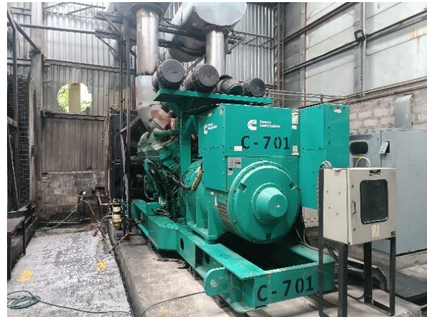
Figura 14 Registro Fotográfico Grupo electrógeno 701 CUMMINS- STAMDFORD
