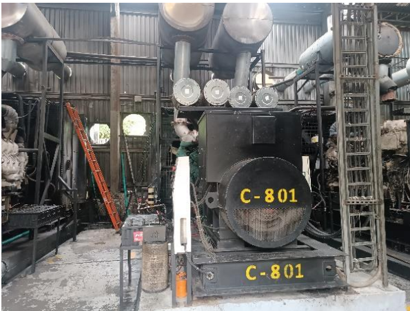
Figura 15 Registro Fotográfico Grupo electrógeno 801 CUMMINS- LEROY SOMER
