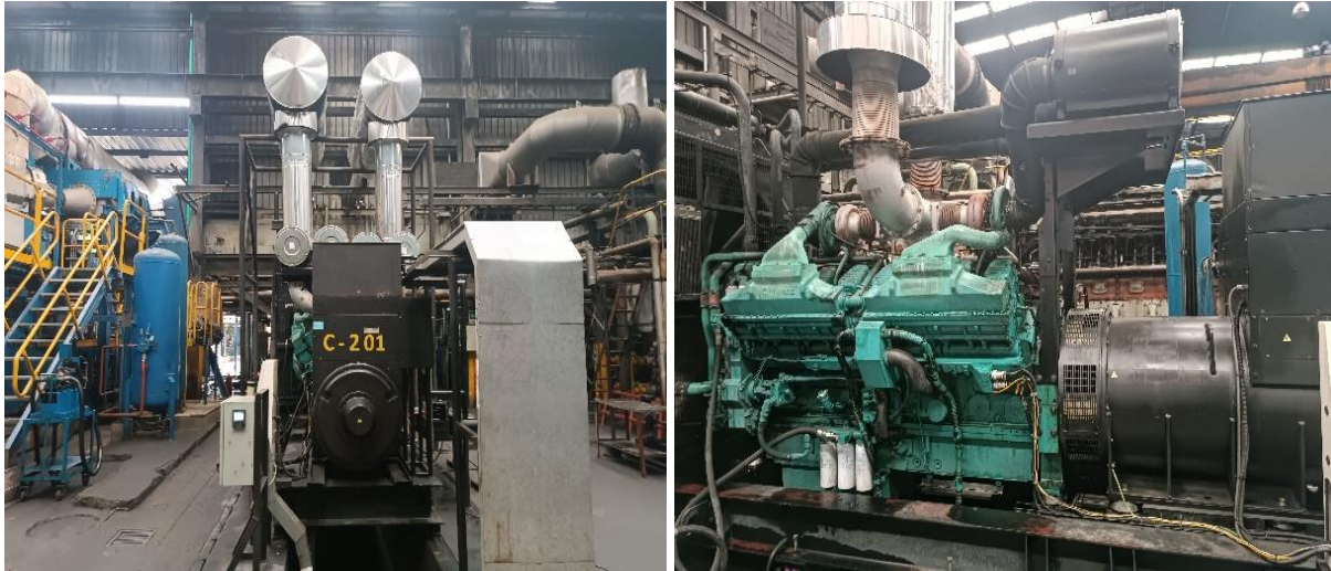
Figura 10 Registro Fotográfico Grupo electrógeno 201 CUMMINS-STAMDFORD
