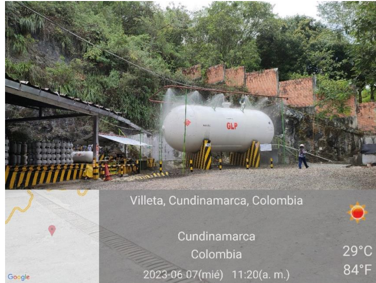
Figura 5. Tanque estacionario de almacenamiento de la planta de envasado de la empresa CLC S.A.E.S.P. en Villeta, Cundinamarca.
