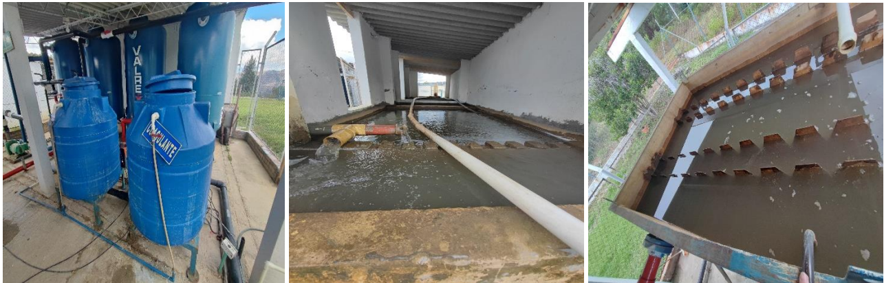
Imagen 12. Módulo de coagulación, floculación y sedimentación.
