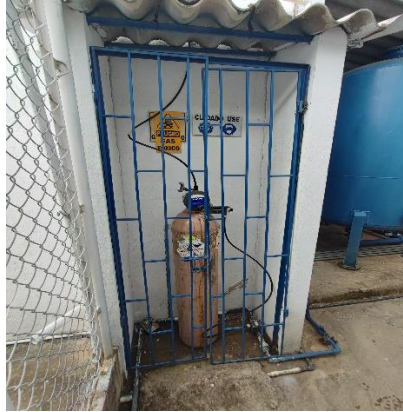
Imagen 14. Módulo de desinfección
