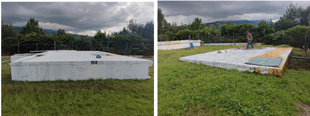
Imagen 15. Tanques de almacenamiento
