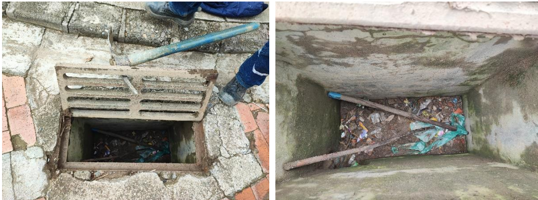
Imagen 17. Sumideros de inspección alcantarillado
