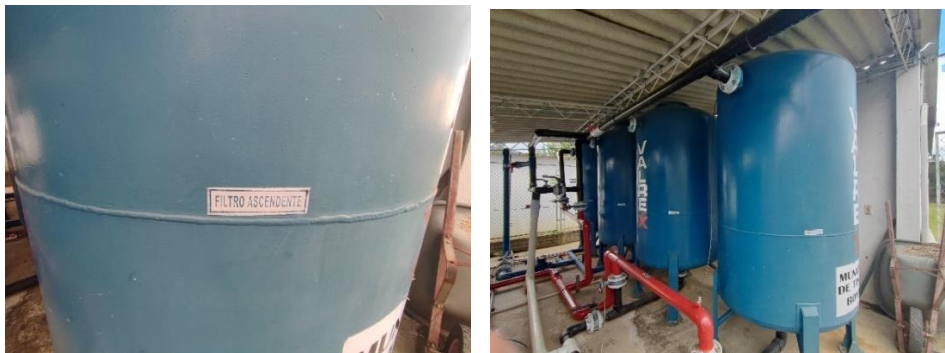
Imagen 13. Unidad de filtrado
