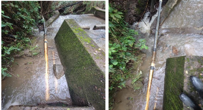
Imagen 9. Línea de aducción "Banquitos"
