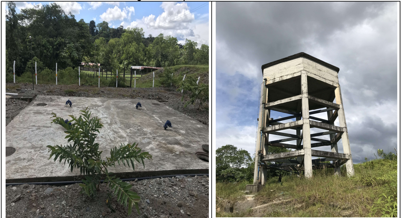
Imagen 23 Tanques de almacenamiento
