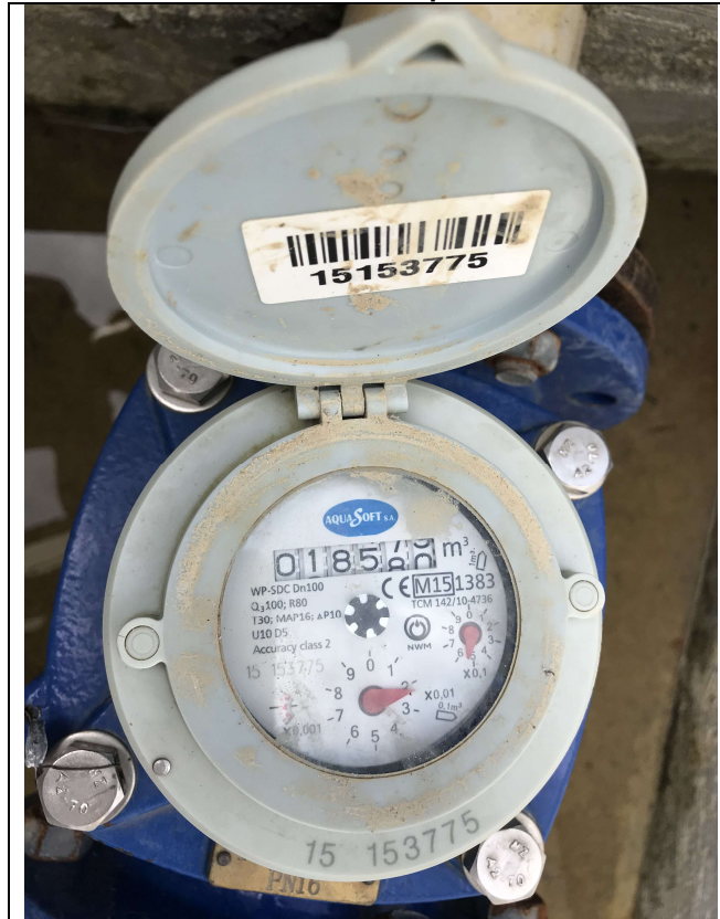
Imagen 24 Macromedidor salida del tanque de almacenamiento elevado
