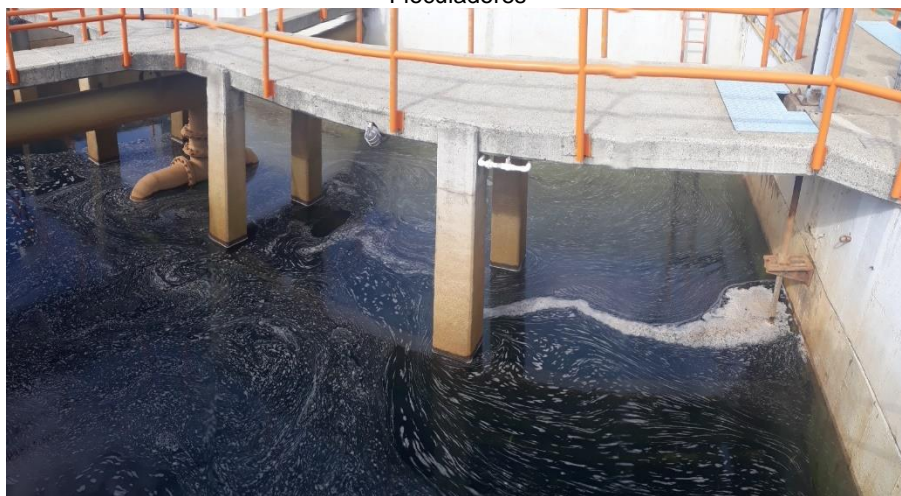
Filtros (Remoción de manganeso, y filtración)
