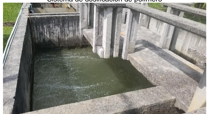
Cámara de reparto
