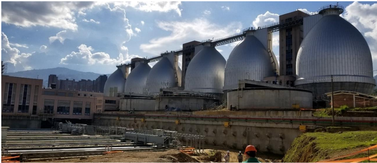
Imagen 31. PTAR Aguas Claras
