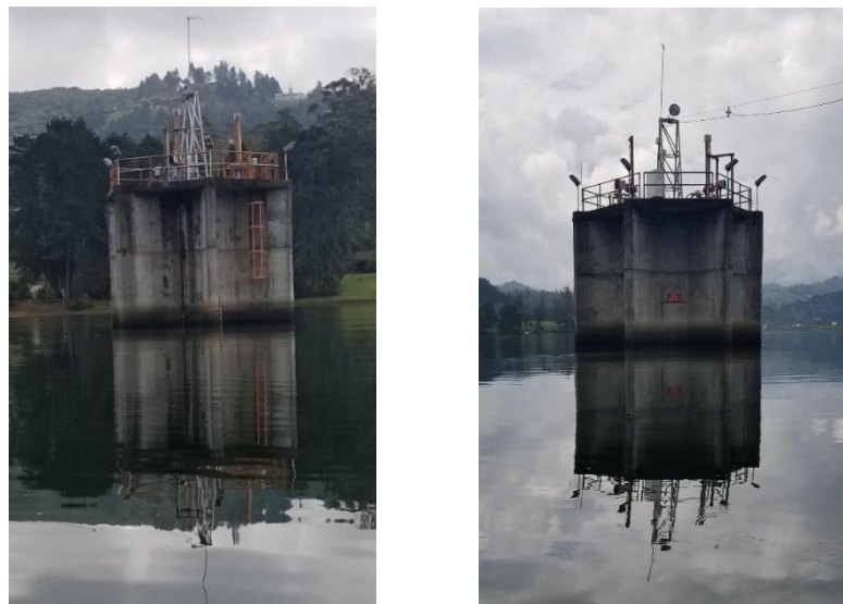
Imagen 5. Torre de captación
