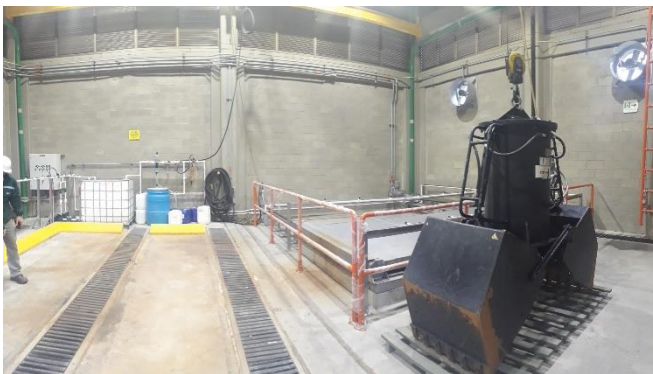
Trampa grasas-ingreso agua residual
