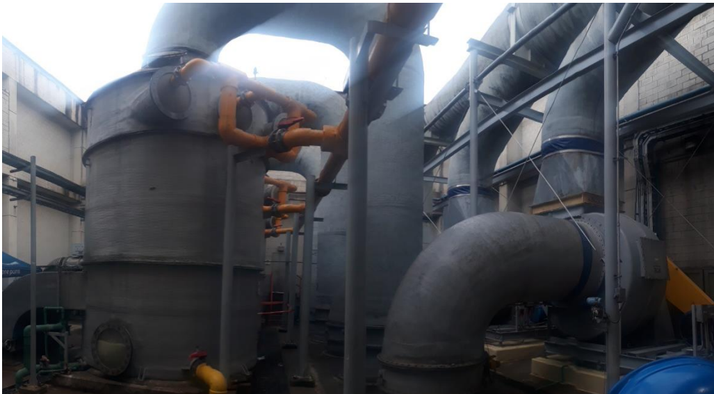
Modulo tratamiento de olores
