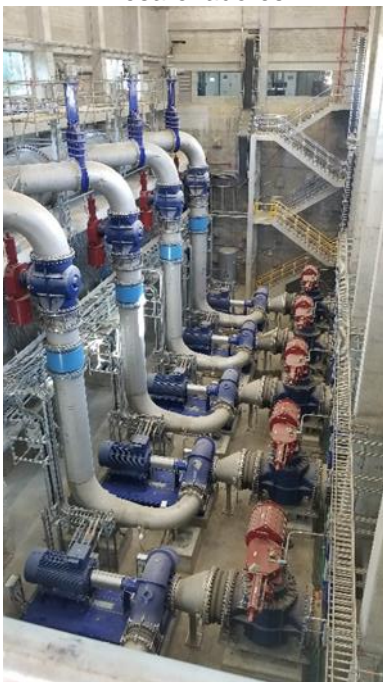
Sistema de bombeo hacia tratamiento primario y secundario
