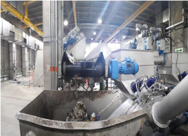
Sistema captación de basuras cribado grueso
