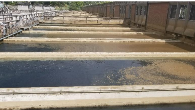
Unidades de filtración
