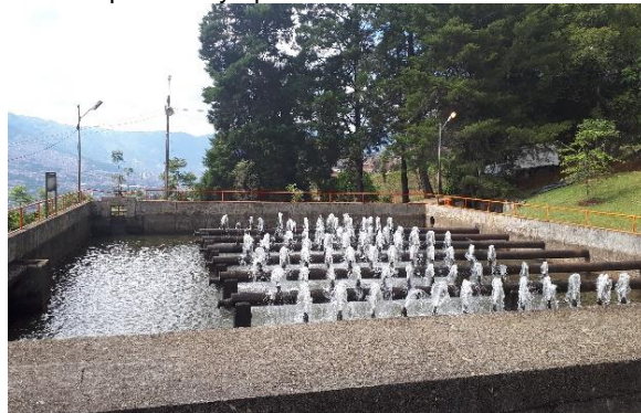
Torre de aireación
