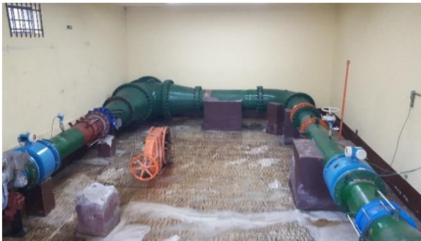
Tubería derivación del caudal captado
