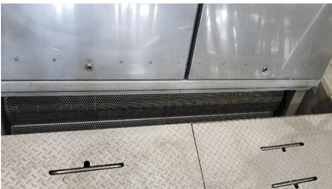
Estructuras de cribado con orificios de 0,8 cm (Detalle)
