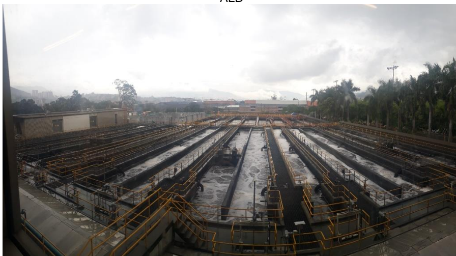
Tanques de aireación, sedimentadores secundarios Fuente: Registro fotográfico SSPD 2018.
