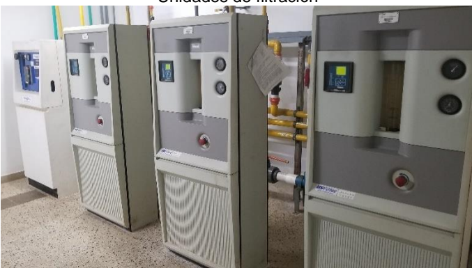
Sistema de dosificación de cloro
