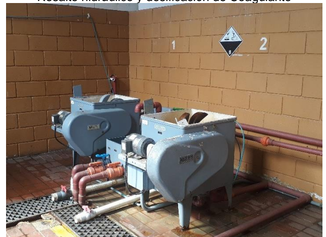
Dosificadores de Sulfato
