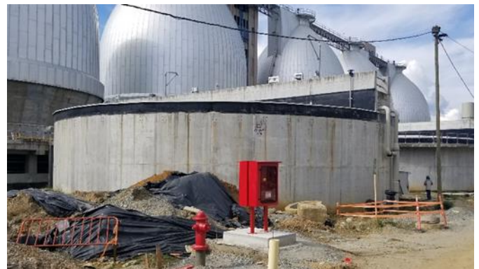
Tanque de espesamiento
