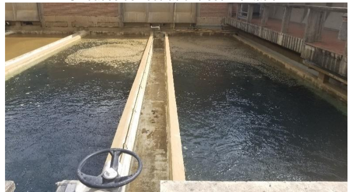
Unidades de filtración
