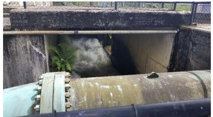
Sistema de bypass de la Central Hidroeléctrica
