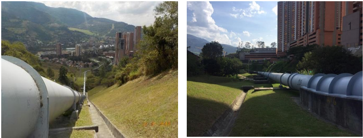
Imagen 14. Tuberías de aducción Sifón – Niquia Manantiales
