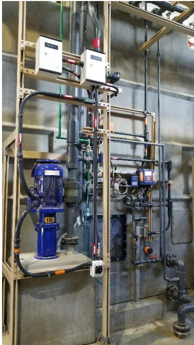
Tratamiento del aire
