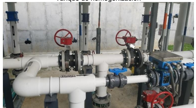
Sistema de bombeo a preespesado
