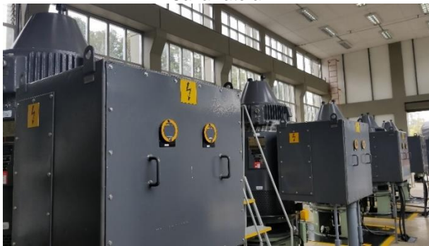
Sistema de bombeo
