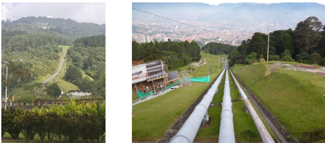
Imagen 6. Tuberías de aducción
