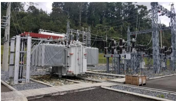
Subestación de energía
