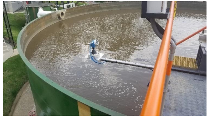
Tanque de homogenización
