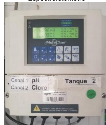
Medición en línea de cloro y pH
