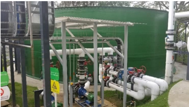
Tanque y bombas de homogenización
