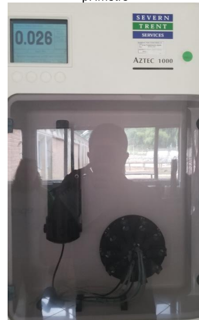
Medición en línea de manganeso
