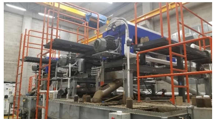
Centrífugas espesadoras (Costados) y deshidratadora (Central)
