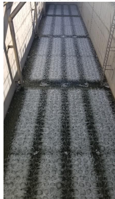
Tanque de aireación
