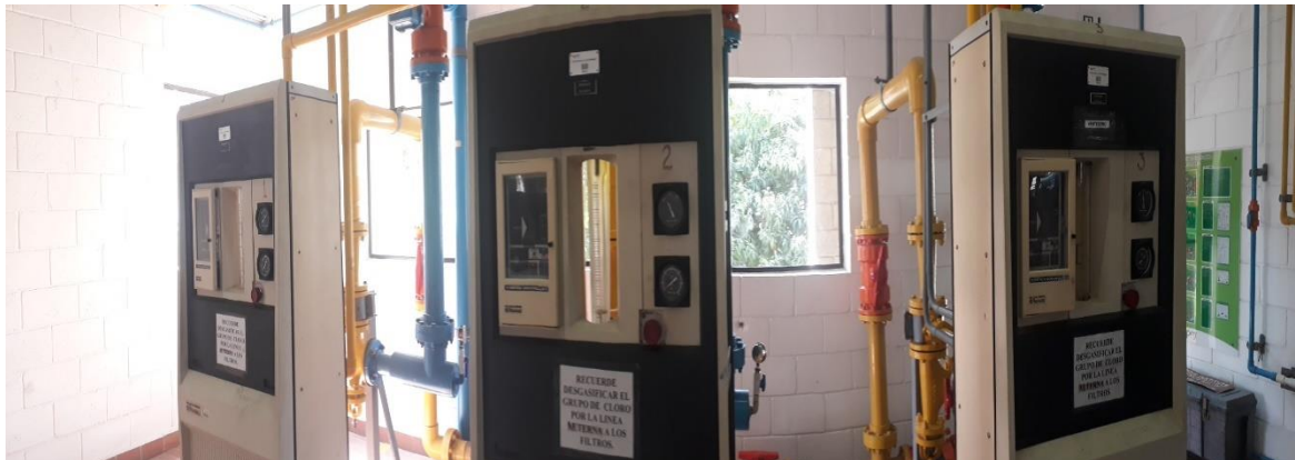
Dosificadores cloro gaseoso
