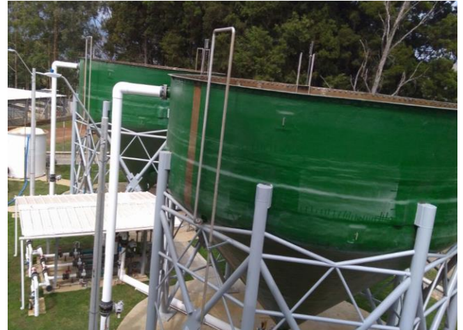
Tanques de pre espesado
