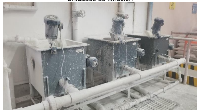
Sistema de dosificación de cal
