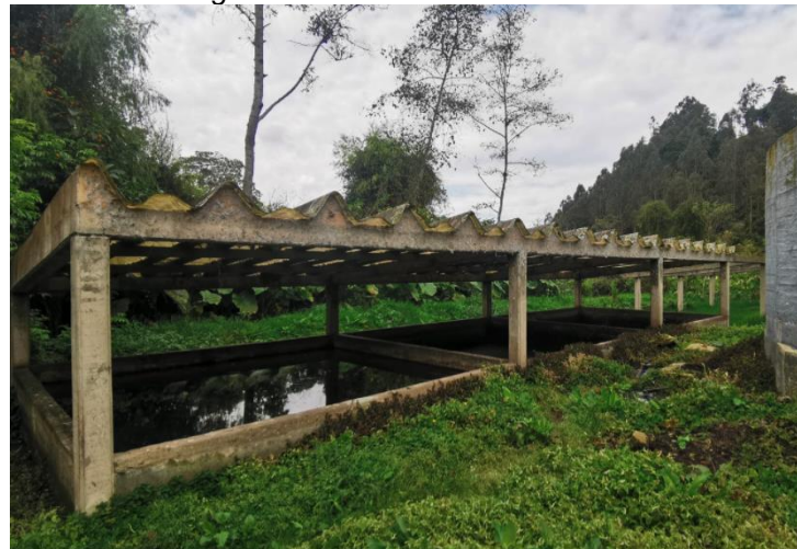
Imagen 7. Lechos de secado de lodos
