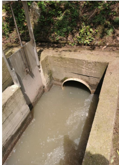
Imagen 3. Desarenador en canal
