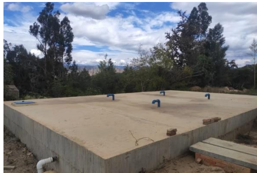
Imagen 41. Tanque de Almacenamiento 4
