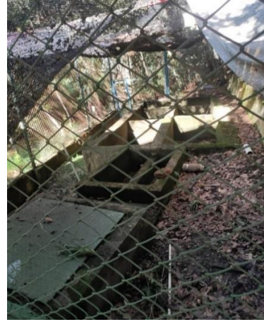
Imagen 13. Sistema de filtración no operativo
