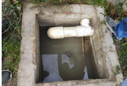
Imagen 44. Macromedidor de salida Sistema pozo profundo
