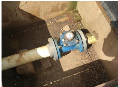
Imagen 42. Macromedidor de entrada a la PTAP compacta
