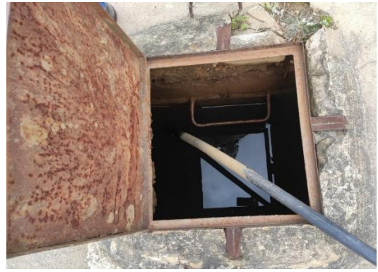
Imagen 40. Tanque de Almacenamiento 3
