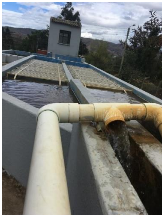
Imagen 18. Planta de Tratamiento Convencional – Dosificación de coagulante
