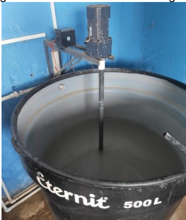
Imagen 26. Sistema de mezcla coagulante
