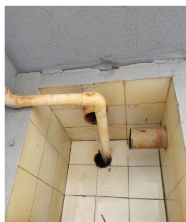
Imagen 23. Punto de dosificación de desinfectante
