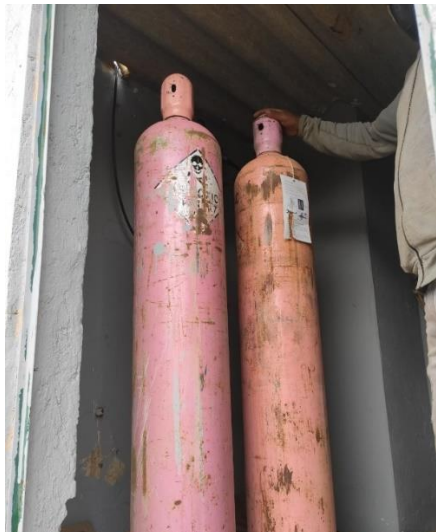
Imagen 28. Punto de dosificación del Cloro Gaseoso
