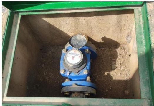
Imagen 43. Macromedidor de salida PTAP compacta
