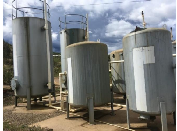
Imagen 17. Planta de Tratamiento Compacta
