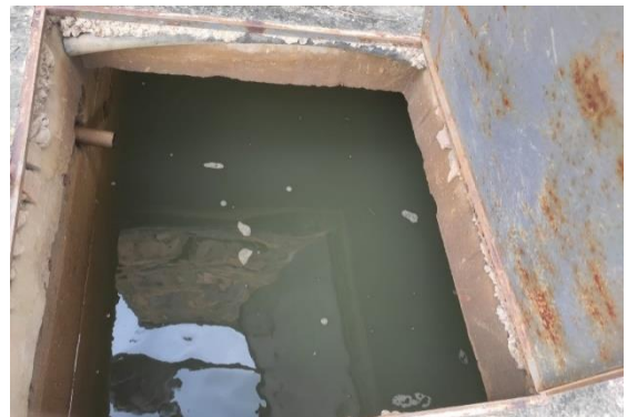
Imagen 38. Tanque de Almacenamiento 2
