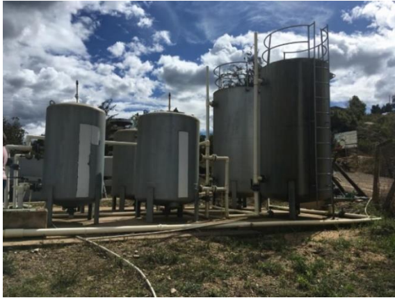
Imagen 16. Planta de Tratamiento Compacta
