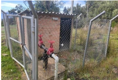
Imagen 8. Captación – Pozo Profundo
