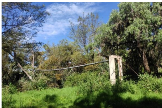
Imagen 15. Paso elevado tubería de aducción
