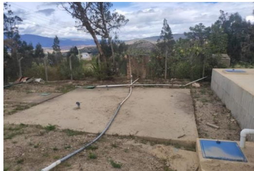
Imagen 36. Tanque de Almacenamiento 1
