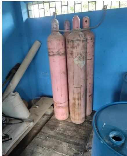
Imagen 29. Punto de almacenamiento del Cloro Gaseoso
