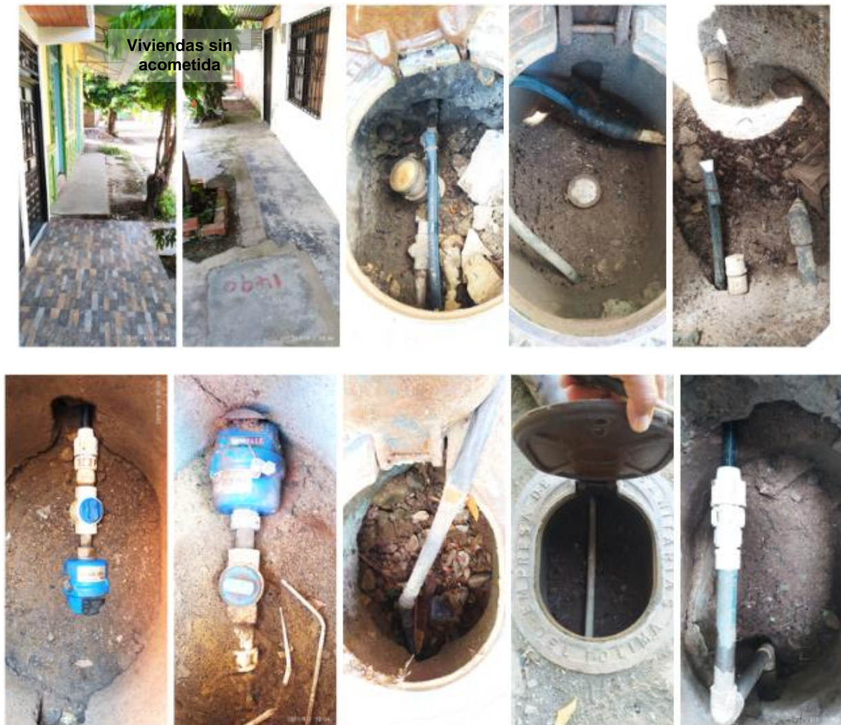
Fuente: Visita de inspección SSPD, 1 al 3 de septiembre de 2021.
