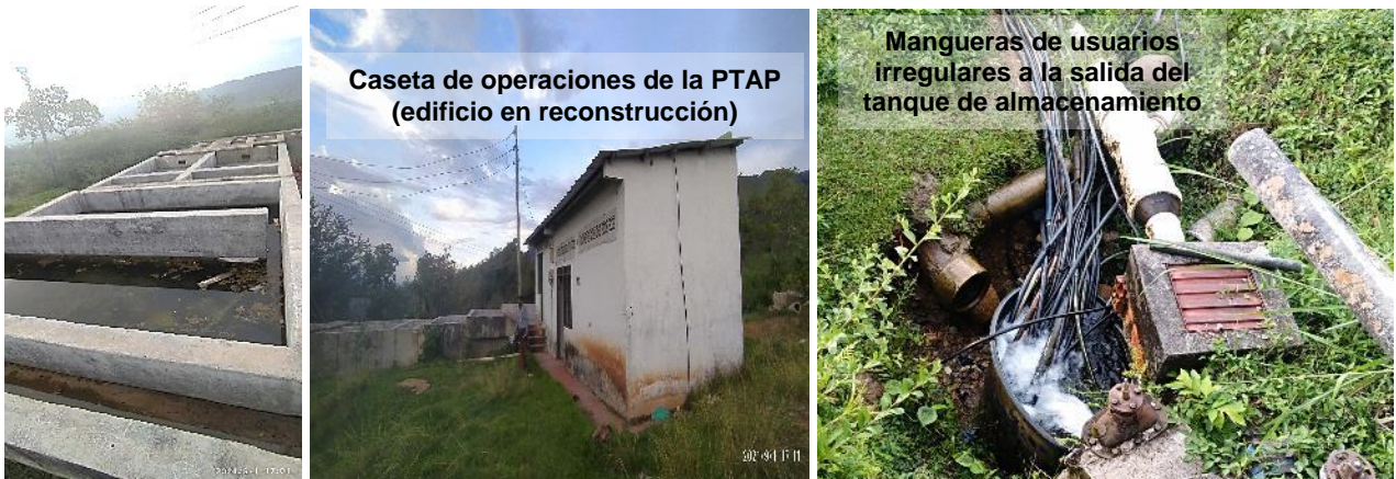
Fuente: Visita de inspección SSPD, 1 al 3 de septiembre de 2021.
