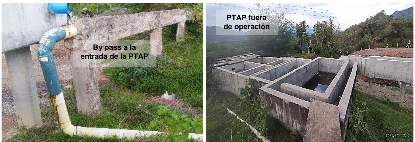
Imagen 22 Estado actual de la PTAP del acueducto urbano de Ataco, Tolima.
