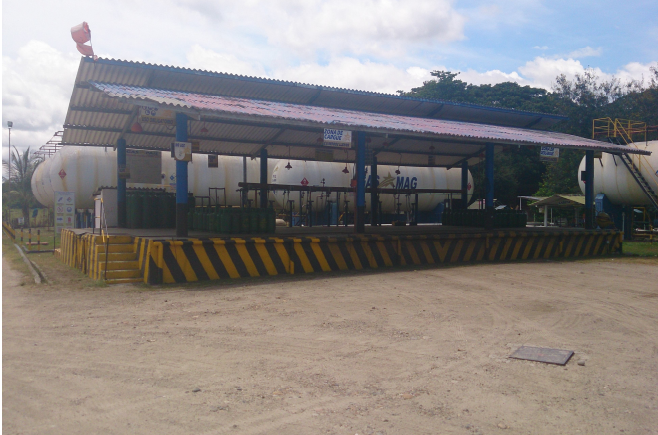
Foto 1. Planta de envasado y almacenamiento de GLP, municipio de Puerto Salgar.
