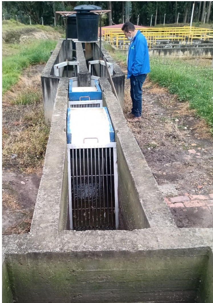
Imagen 1. Cribado y desarenadores
