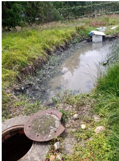
Imagen 12. Infraestructura de la PTAR San Isidro afectada por bloqueo de la tubería de ingreso
