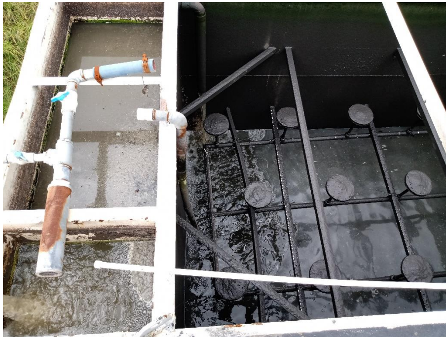
Imagen 15. PTAR La Floresta fuera de funcionamiento
