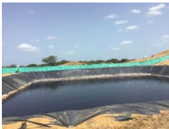
Imagen 24: Piscina de Lixiviados
