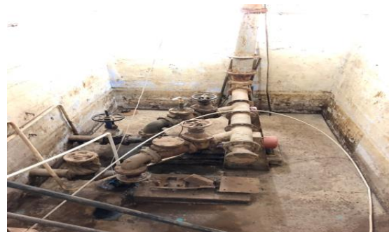
Imagen 48 Sistema de bombeo
