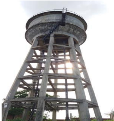
Imagen 36 Tanque Elevado la Victoria
