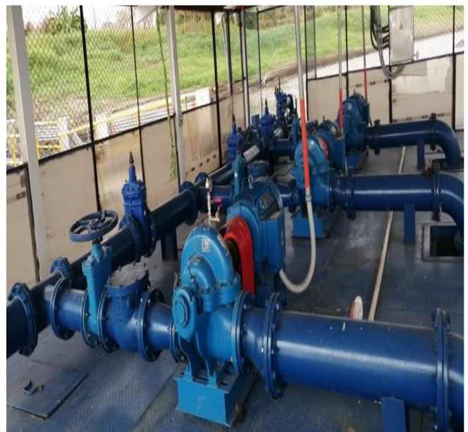
Imagen 16 Equipos de bombeo de la Barcaza
