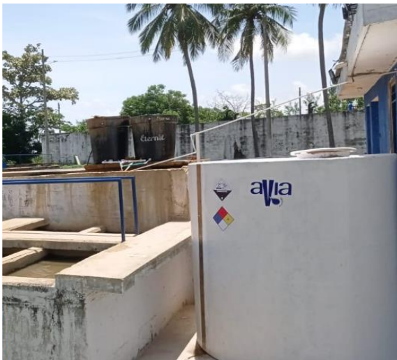
Imagen 25 Tanque Almacenamiento Coagulante
