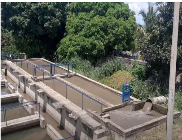
Imagen 23 Desarenador: Cámara de aquietamiento y entrada al desarenador
