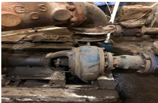
Imagen 47 Bomba de la estación de la EBAR
