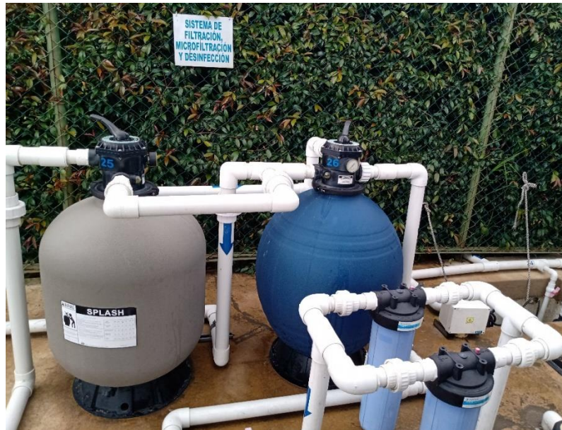
Imagen 15. Sistema de filtración y desinfección
