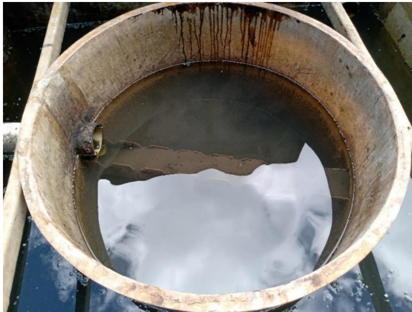
Imagen 9. Clarificador identificado en visita
