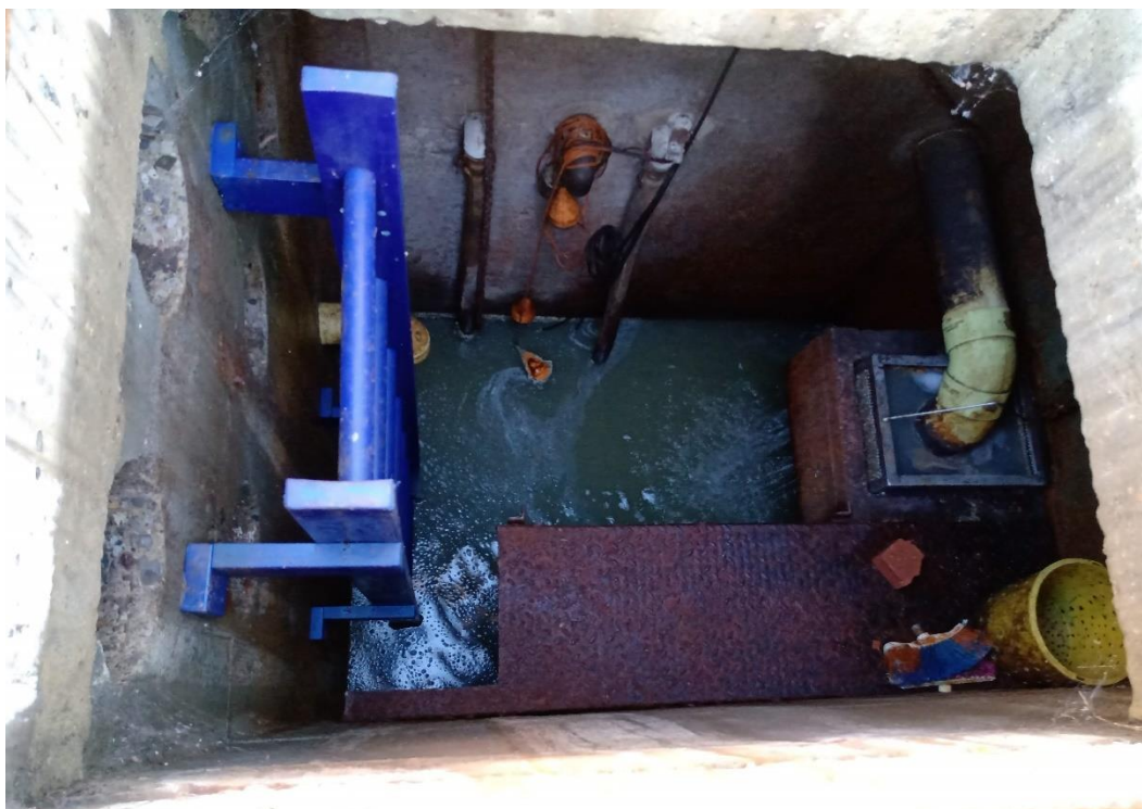
Imagen 11. Cribado y homogenización – PTAR Reserva de Moraverde
