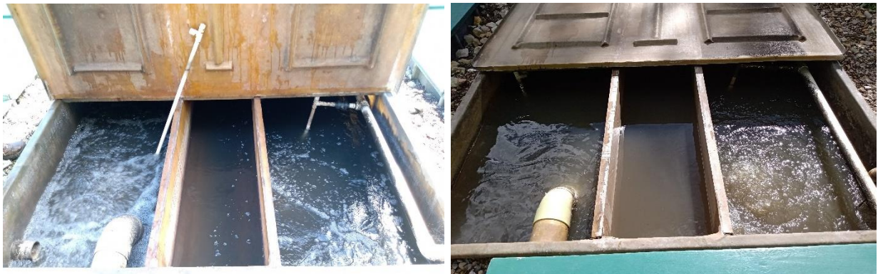
Imagen 8. Tanque de aireación 1 (izquierda) y 2 (derecha).
