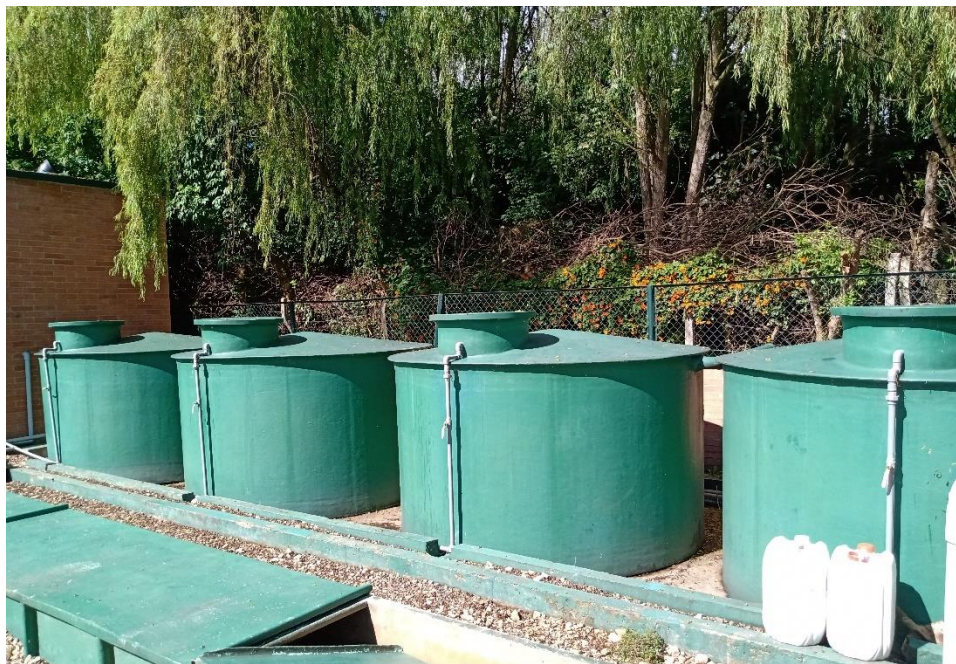
Imagen 6, Tanques de homogenización.
